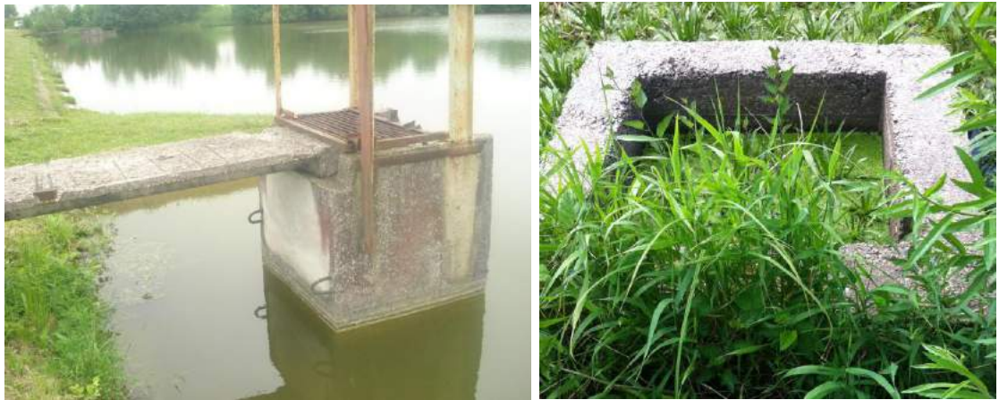
5.8 Pav. Pav. Šachtinė pralaida. Kairėje - įrengta tvenkinyje. Dešinėje - Šyšos polderyje ant griovio R-5-6.
